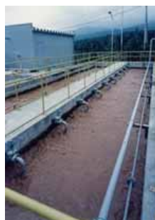
嫌気好気活性汚泥処理装置
