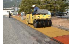
色彩性、施工性に富んだCSアスファルトによる舗装工事
