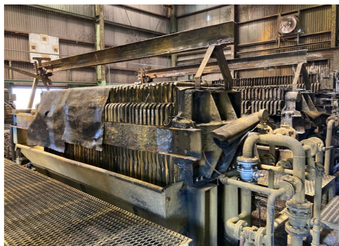
污水处理压滤机 (小野田事业所)
