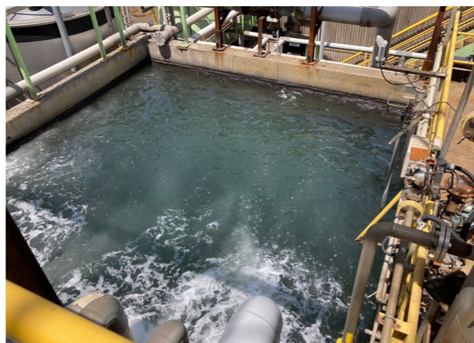
污水处理设施 (小野田事业所)
