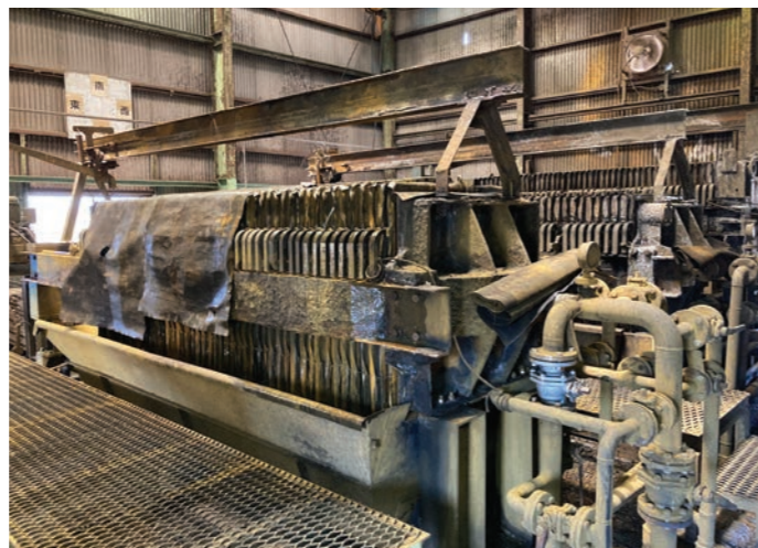
排水処理フィルタープレス（小野田事業所）
