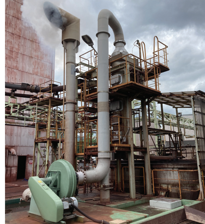
熱処理炉 排ガス処理装置（大竹事業所）
