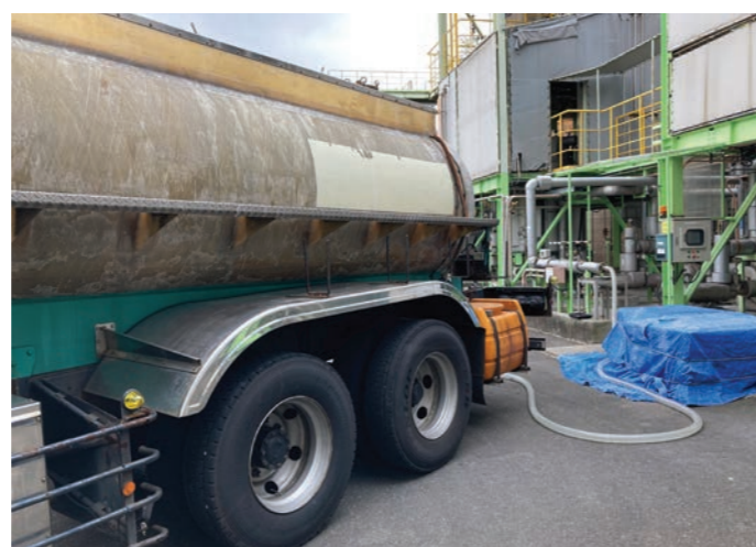
バリウム廃液積込設備 (小野田事業所)
