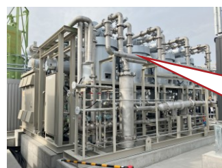
CO 2 回収実証装置
